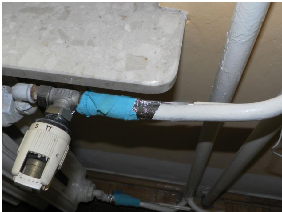
Sondy temperaturowe na zasilaniu i powrocie
